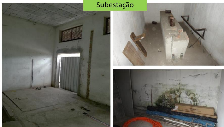
Figura 5 - Situação em 2017: subestação de energia elétrica, salas de aula e laboratórios.
