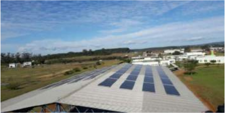
Figura 14 - Usina fotovoltaica com 256 placas.
